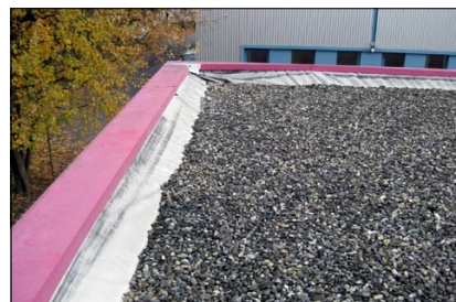
Membrane d'étanchéité qui s'est rétractée.
