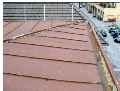
Cette tôle est en bien mauvais état, mais on peut la sauver...
