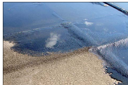
Étanchéité multicouche traditionnelle non protégée après seulement 5 ans.
