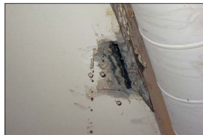
Fuite d'eau au plafond d'un restaurant.
